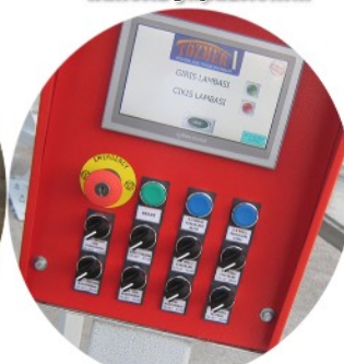
The Control Panel Панель управления
